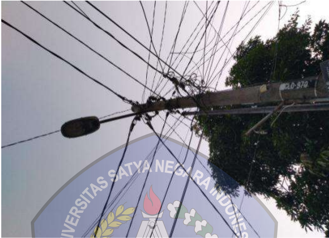
Gambar 4.2.4 lampu penerangan jalan dikawasan Rw 05
